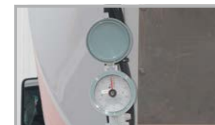
Contador de água
