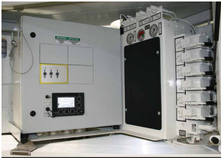
SISTEMA DE CONTROL DE BOMBA ERGONIC (EPS)
