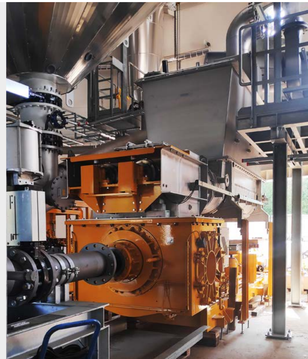
La KOS 25100 con grupo hidráulico y doble transportador de tornillo para transportar biomasa al depósito de fermentación
