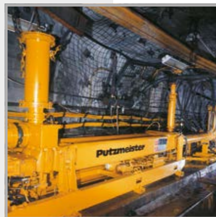
Bomba modelo HSP 3080 trabajando en minería subterránea
