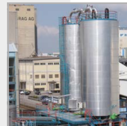
Dos silos de almacenamiento de 200 m³ para el almacenamiento de lodos cloacales (Pro Rheno, Suiza)
