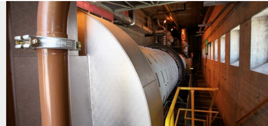
Planta de tratamiento de aguas cloacales Erzo Oftringen (Suiza): Horno rotatorio para la incineración de lodos cloacales
