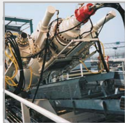
Transportador sinfín con dos bombas de escombros tipo KOS 1480, túnel Botlek, Países Bajos
