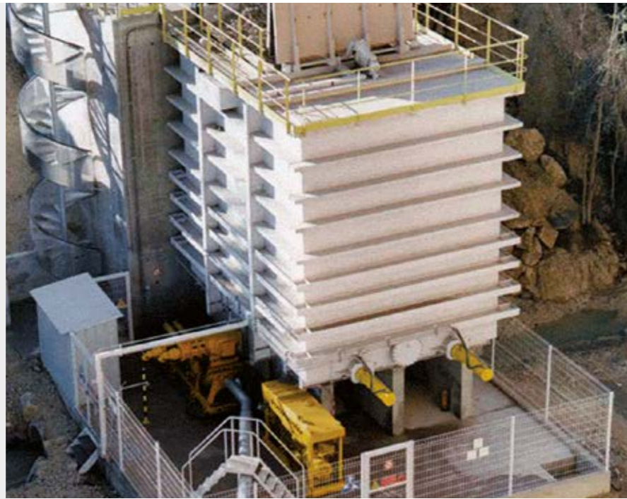
Coincineración de combustibles alternativos en la fábrica de cemento Le Teil Lafarge, Francia
