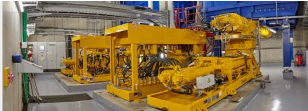
2 tolvas de recepción de lodos de 60 m³ cada una con sistema de descarga de bastidor deslizante, tornillo de descarga de tolva de doble eje, bomba de materia gruesa KOS 1080 HP
