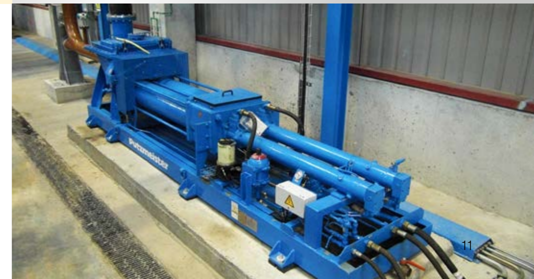
Bomba de recirculación KOS 1070 para la recirculación de los residuos de la fermentación
