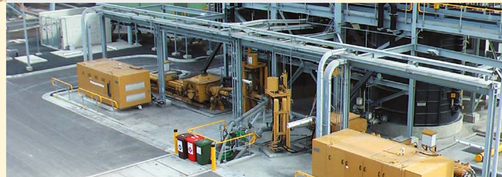
Cenizas volantes y de fondo de horno, unidad de bombeo KOS 25100 (Kogan Creek, Australia)
