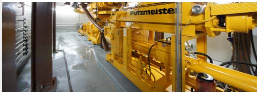
Fondo: Bomba de pistón KOS 1080 bajo un búnker de recepción de 30 m³. Primer plano: bomba de inyección KOS 1030 para alimentar las dos líneas del horno bajo un silo de almacenamiento de 230 m³. Instalado en un antiguo depósito de residuos.
