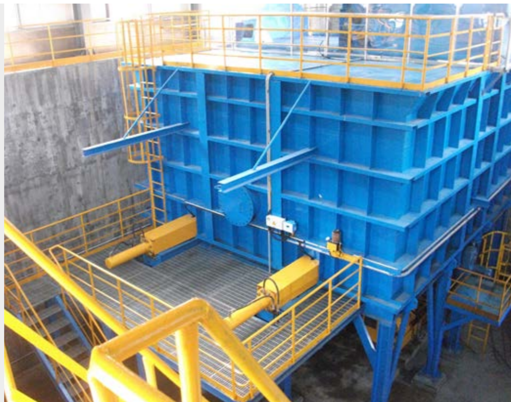
Arriba: Los cilindros de accionamiento ubicados en la base del silo son una solución probada que ahorra espacio.
