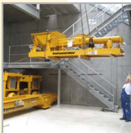
Nueva instalación en la planta de tratamiento de aguas residuales de Neu-Ulm, Alemania
