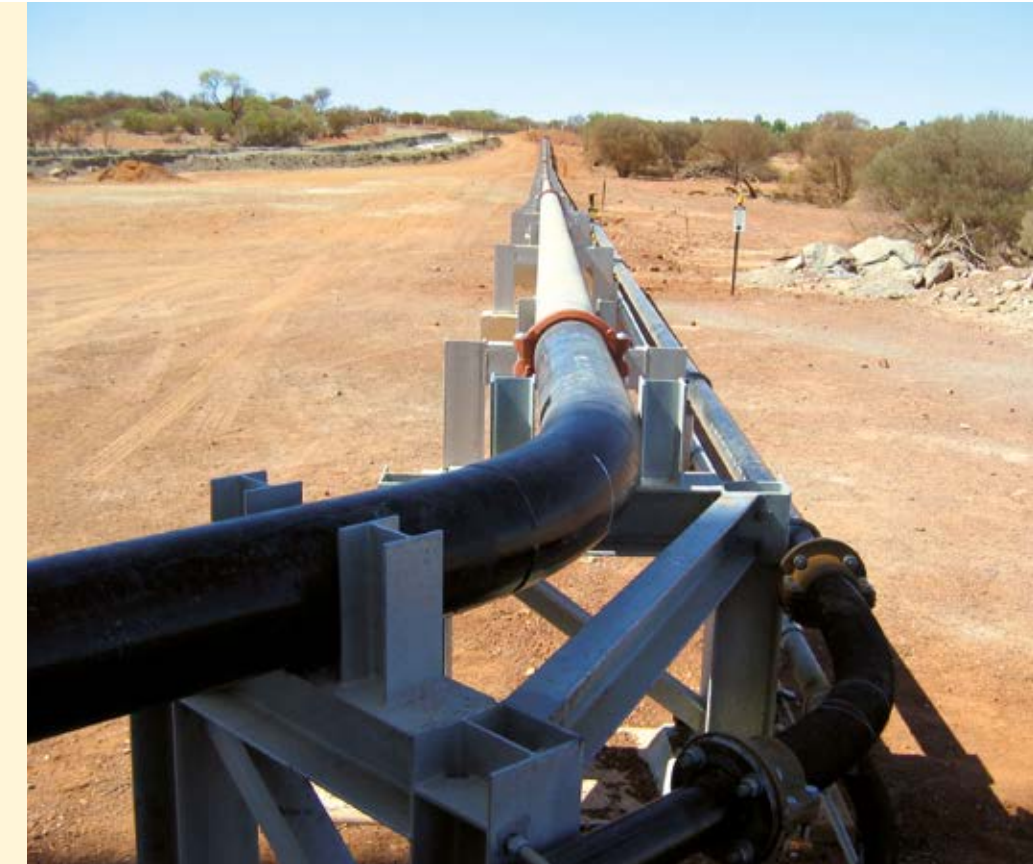
Atık cevher transfer iletim hattı
