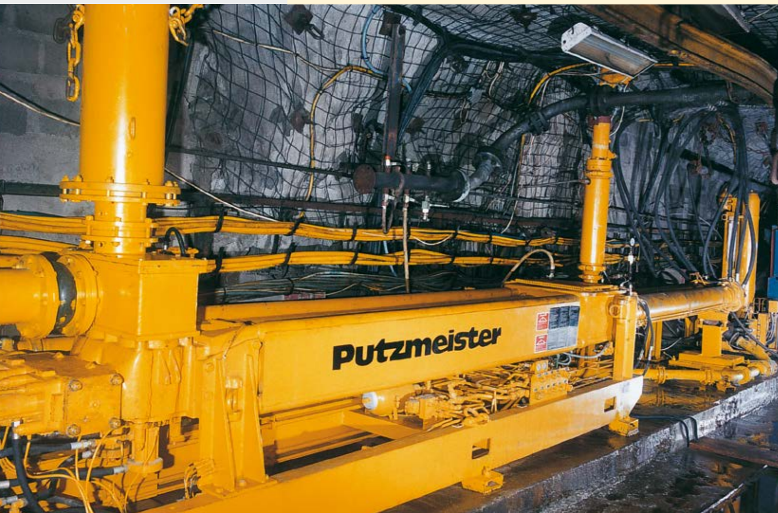
Насос типа HSP во время эксплуатации под землёй
