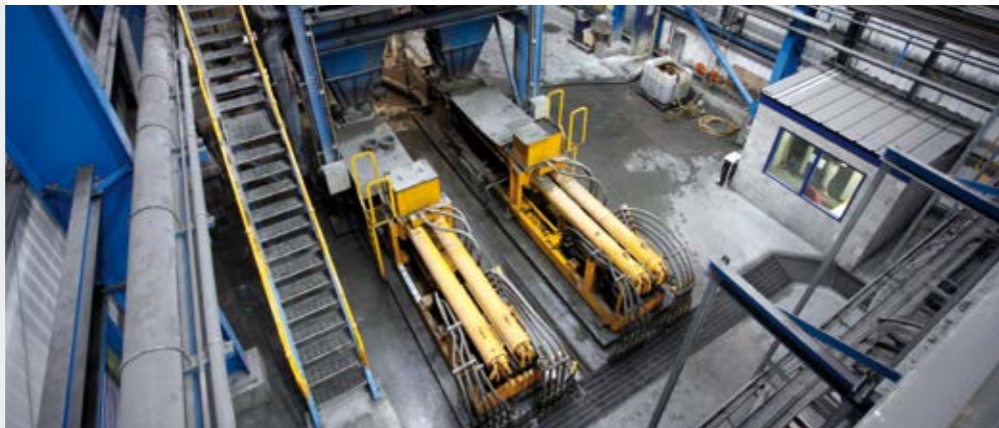
Два насоса типа HSP 25100 с устройством поддержания постоянного давления для сглаживания пиков на свинцово-цинковом руднике Лишин, Ирландия
