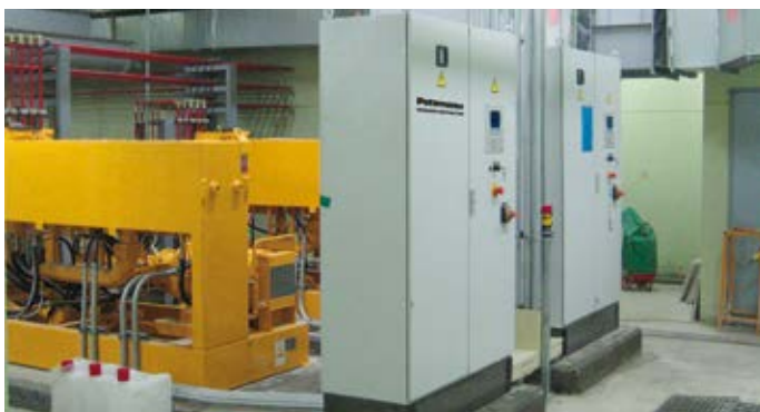
Шкаф управления на заводе по переработке сточных вод Gulpocheon (Южная Корея)
