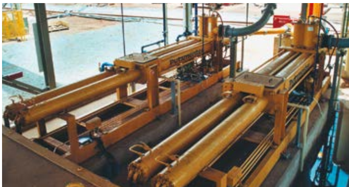
Два насоса по перекачке хвостов обогащения типа HSP 25100 на золотом прииске в Бульяххулу (Танзания)
