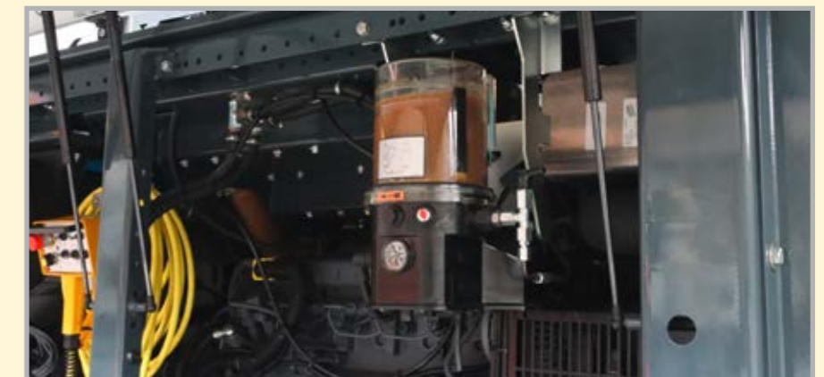
La centrale de graissage électrique fait économiser du temps de travail et diminue l'usure
