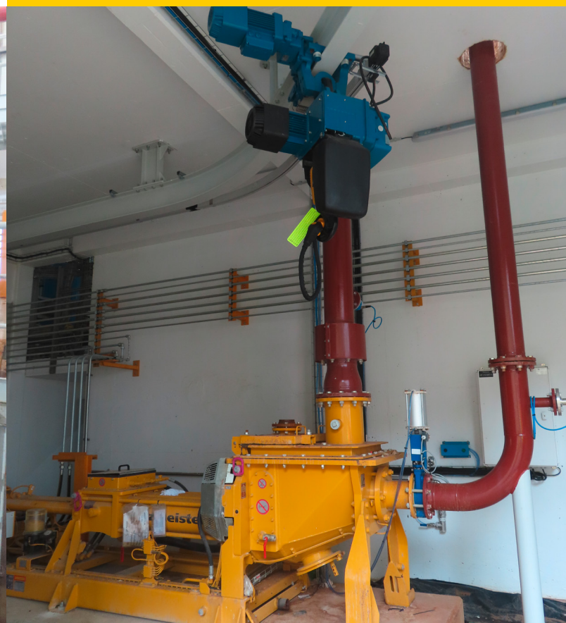
Troisième pompe de recirculation
