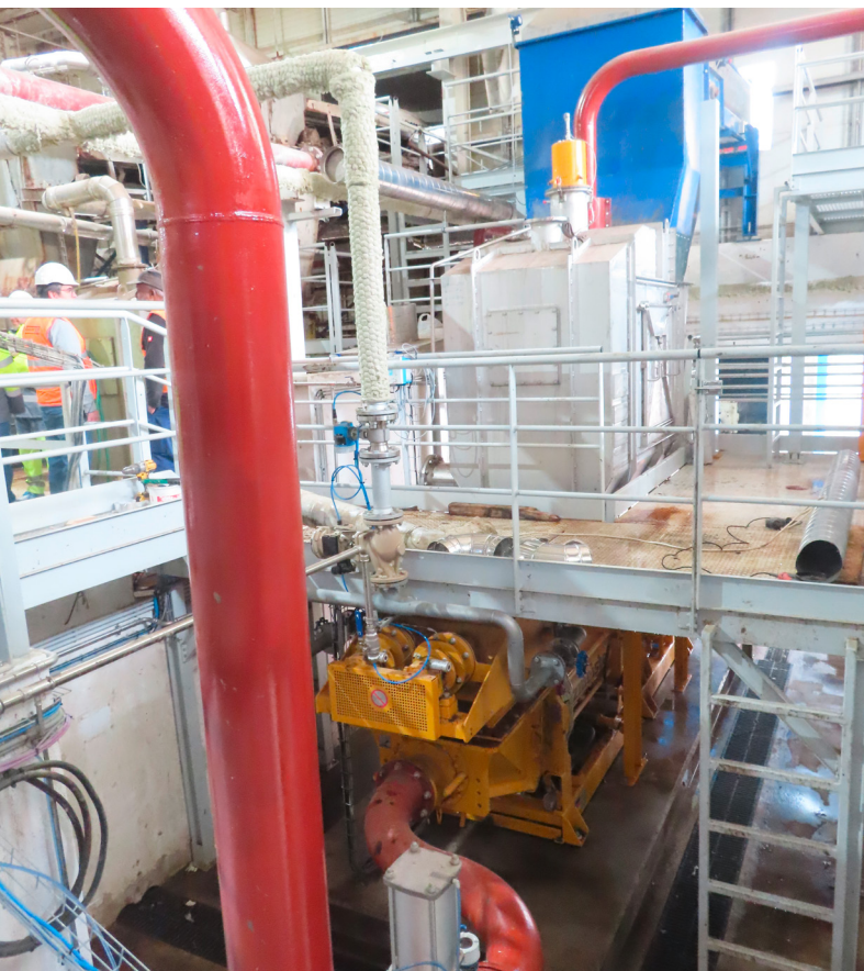
Tolva de recepción, transportador de tornillo y bomba de alimentación de la tercera línea. También se pueden ver las tuberías de recirculación hasta la tolva de recepción
