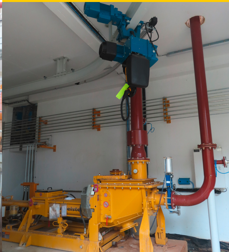
Tercera bomba de recirculación
